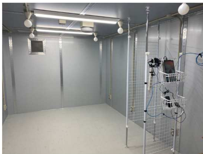
図 1.4 電波暗室（情報科学研究棟 B602 号室）
