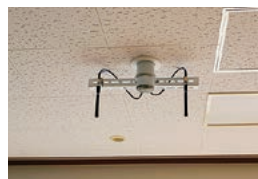
ローカル5Gシステム (アンテナ部)
