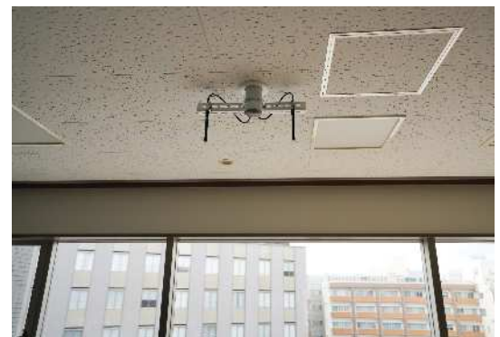
図1 運用を開始したローカル5Gシステム(アンテナ部)
